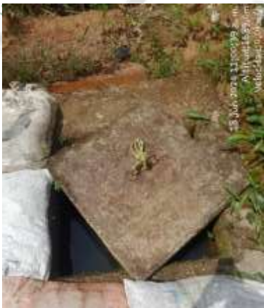
Fotografía 2. Tapa del tanque de almacenamiento de lixiviados y agua lluvia. Fuente: Cornare 2024
