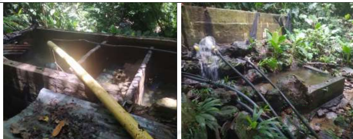
Figura 5 y 6. Tanque de almacenamiento del predio 6.
