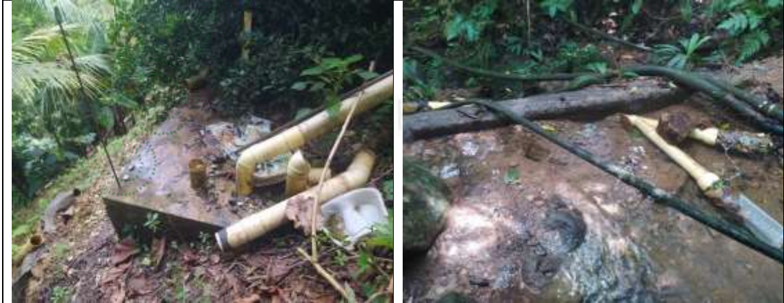
Figura 3. Tanque séptico del predio 5.
