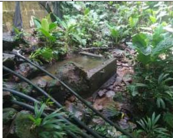
Figura 10. Obra de captación del predio 8.
