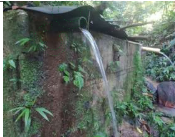
Figura 9. Tanque de abastecimiento y desarenador del predio 7.
