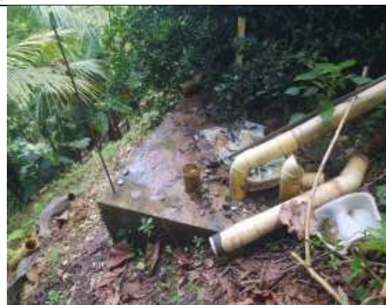
Figura 3. Tanque séptico del predio 5.
