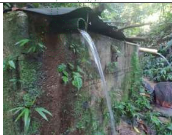
Figura 9. Tanque de abastecimiento y desarenador del predio 7.
