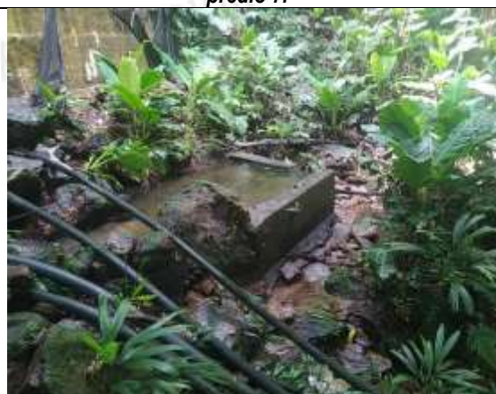
Figura 10. Obra de captación del predio 8.
