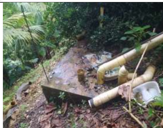
Figura 3. Tanque séptico del predio 5.
