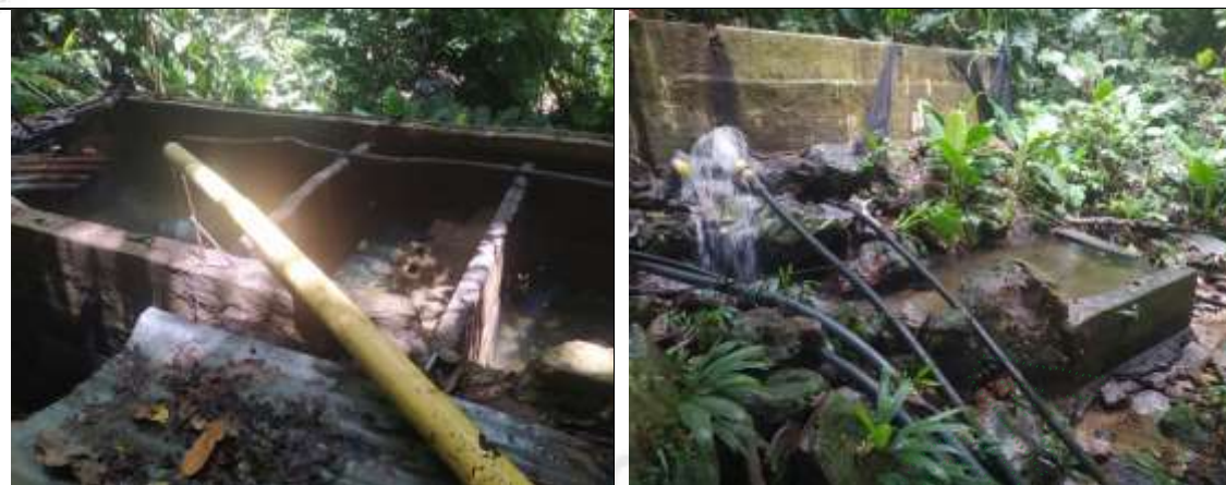
Figura 5 y 6. Tanque de almacenamiento del predio 6.
