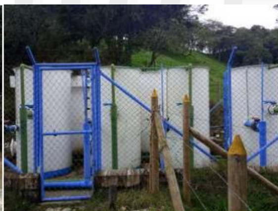
Planta de tratamiento
