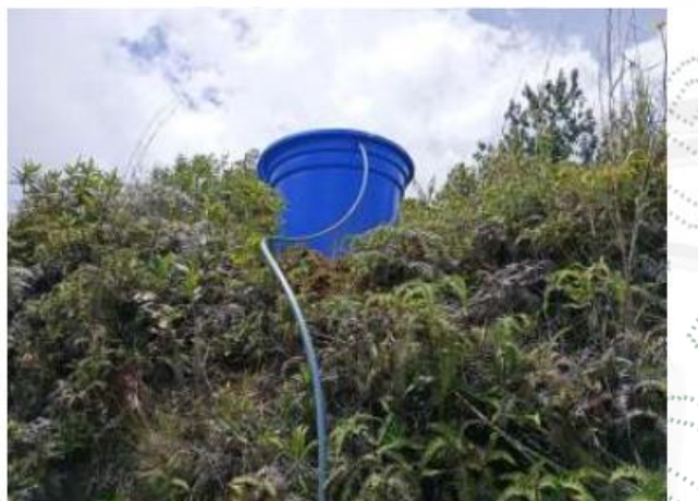
Tanque de almacenamiento
