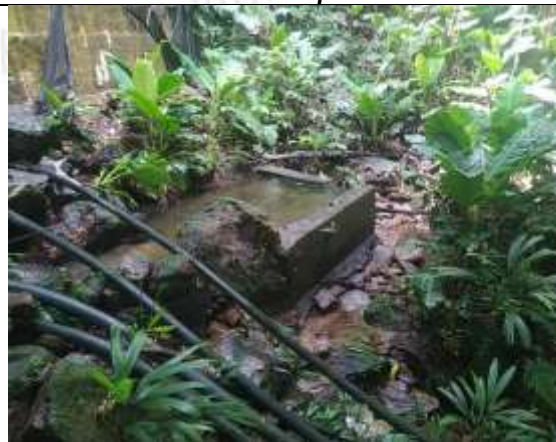
Figura 10. Obra de captación del predio 8.
