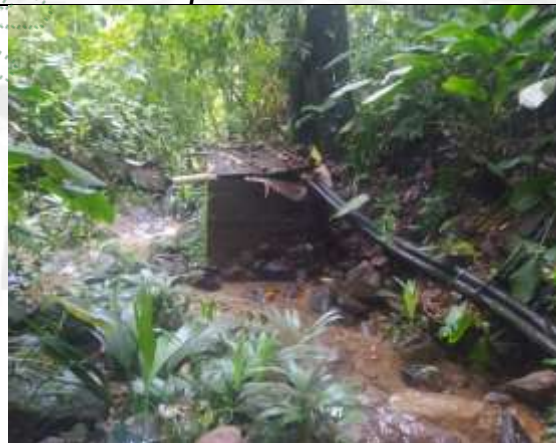
Figura 8. Tanque de abastecimiento y desarenador del predio 7.
