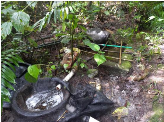
Imagen 1. Obra de captación artesanal.
