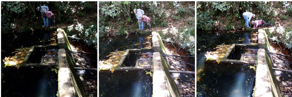
Fotos de la bocatoma del acueducto de la vereda Purima.
