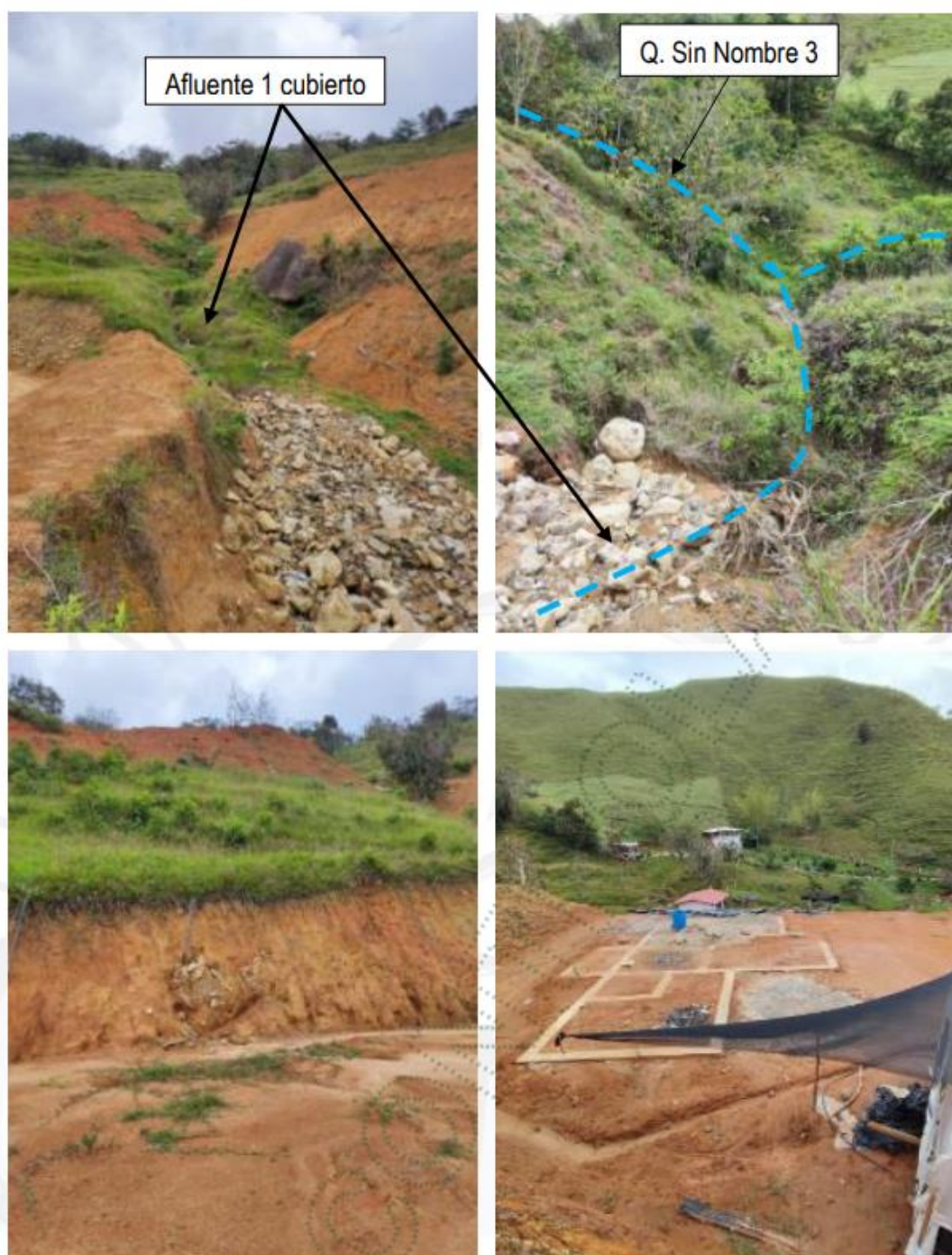
Foto 3. Movimiento de tierras y afectación del Afluente 1. Fuente: Cornare, 2024.
