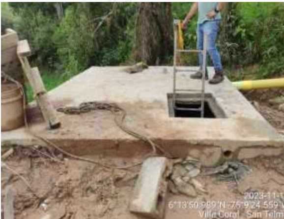
Tanque de bombeo
