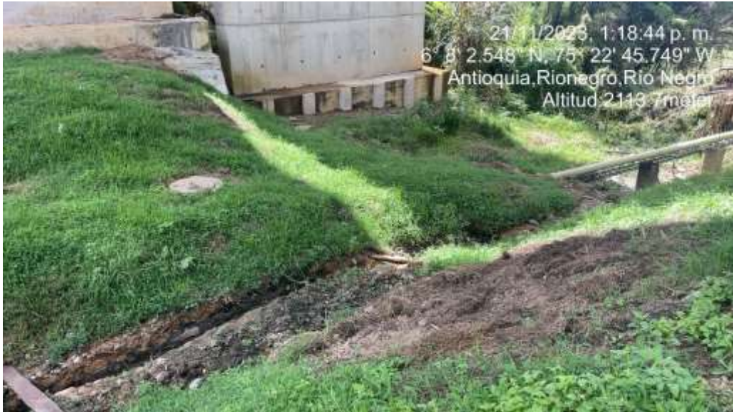
Punto donde se encontraba la tubería y el lleno mencionado.
