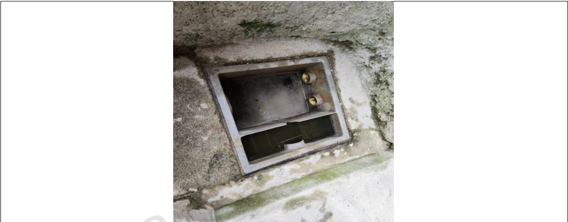
STARD (Sistemas primario y secundario) y caja de salida del sistema de tratamiento
