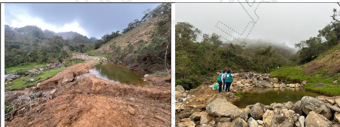
Figura 8. Estado ocupación de cauce sobre la Quebrada El Viadal
