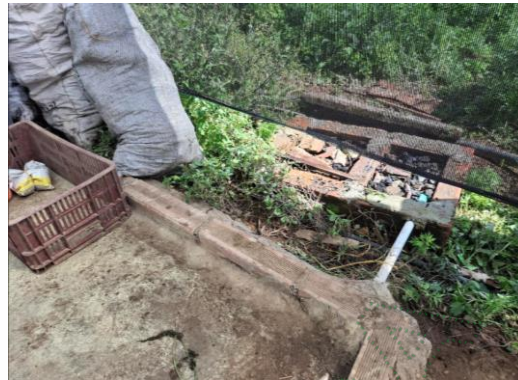
Imagen 5. Caja de desagüe
