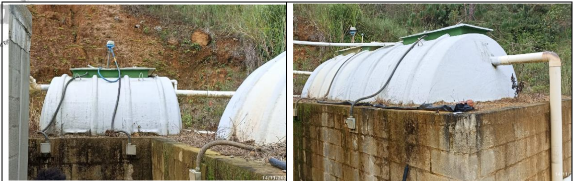
Sistema de tratamiento de Aguas Residuales N°2
