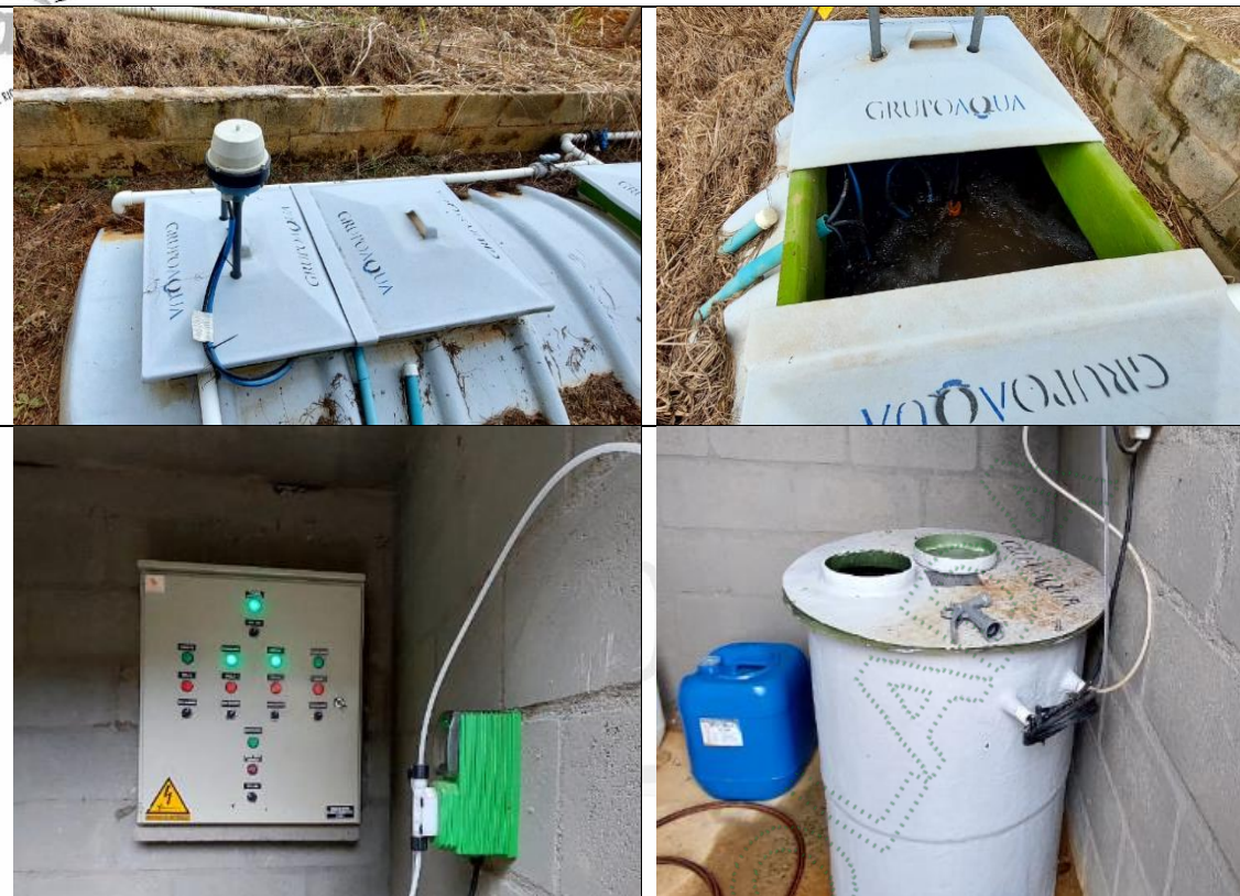
Sistema de Tratamiento de Aguas Residuales N° 1
