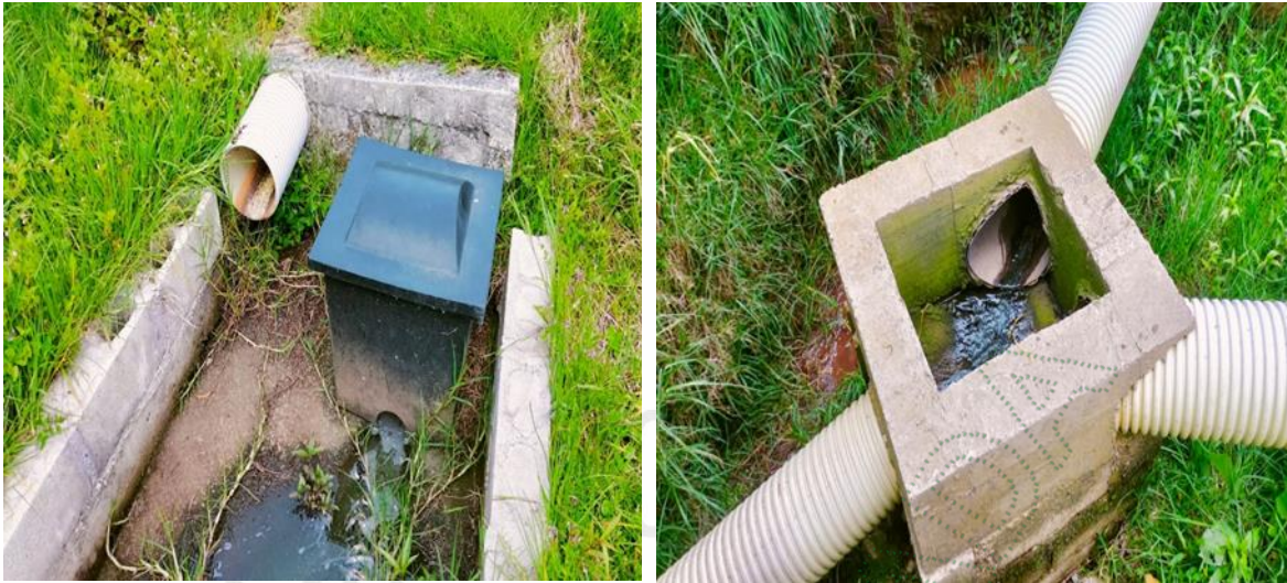
Ilustración 4: Infraestructura del sistema de tratamiento y colector.
