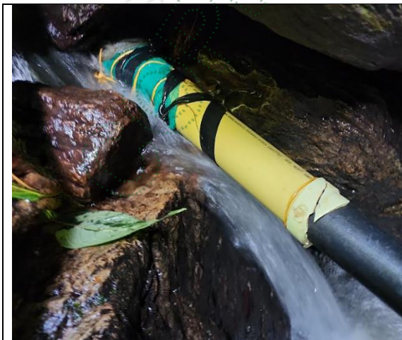
Imagen2. Captación con manguera de diámetro de 2” - Cornare2024
