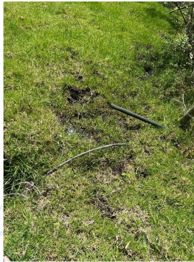
Imagen 3. Tubería anteriormente implementada por la usuaria
