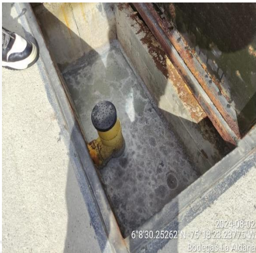
Trampa de grasas externa
