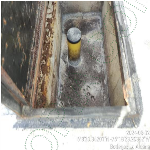
Trampa de grasas externa
