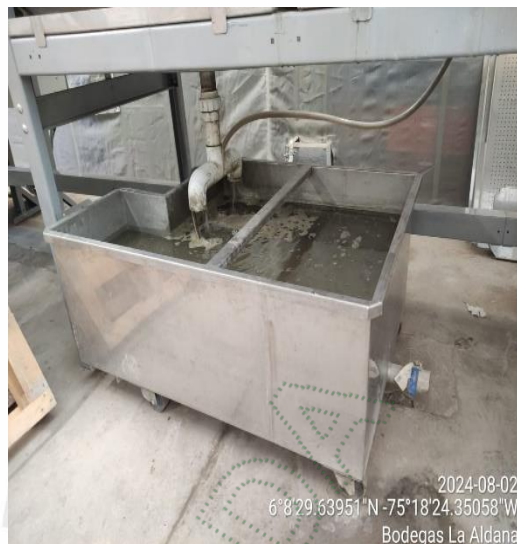
Almacenamiento agua lavado
