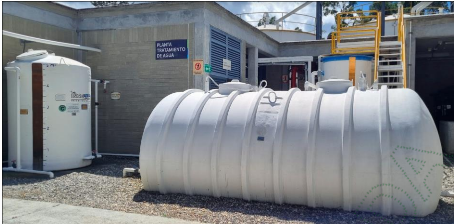
Imagen 4. Planta de tratamiento aguas lluvias-CORLANC
