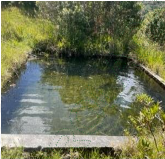
Imagen 4. Tanque de almacenamiento y distribución
