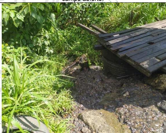
Figura 13. Vertimiento de AR de lavado de vehículos sin previo tratamiento a la fuente.
