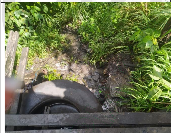
Figura 14. Vertimiento de AR de lavado de vehículos sin previo tratamiento a la fuente
