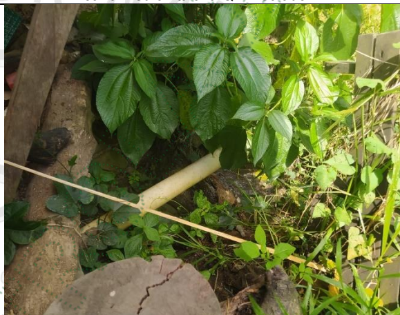
Figura 21. Tubería de descarga de AR del hospedaje y restaurante El Descanso.
