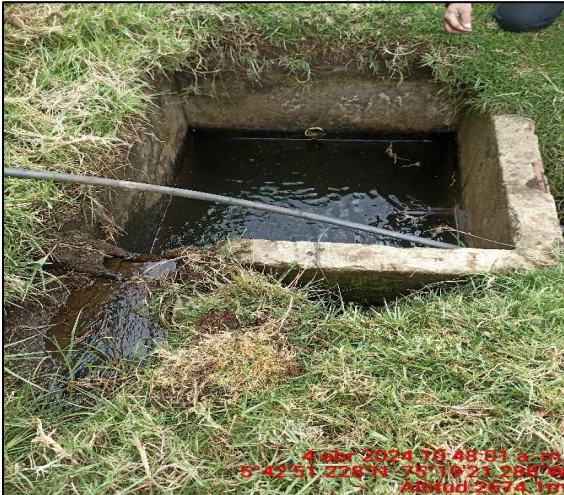
Tanque toma del agua y distribución
