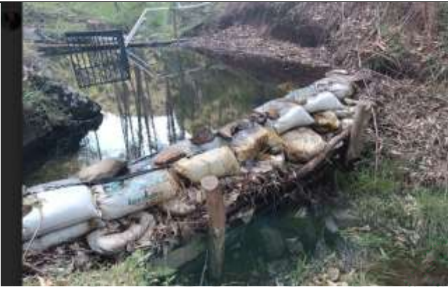
CAPTACION LA LAJA PUNTO 3
