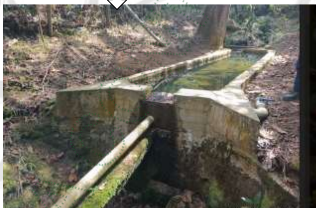
CAPTACION LA LAJA PUNTO 2
