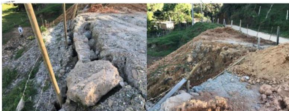
Figura 6. Lleno antrópico y agrietamiento del suelo dispuesto en la ladera
