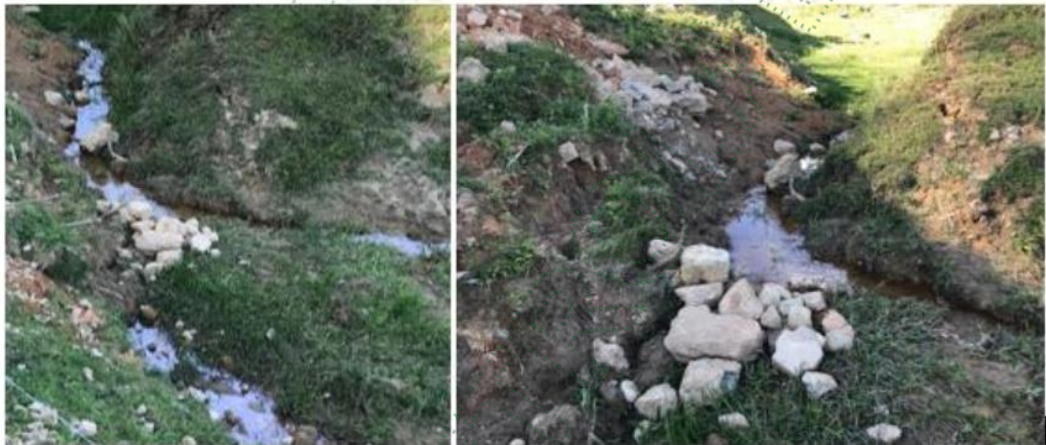
Figura 4. Obstrucción de flujo del cauce natural
