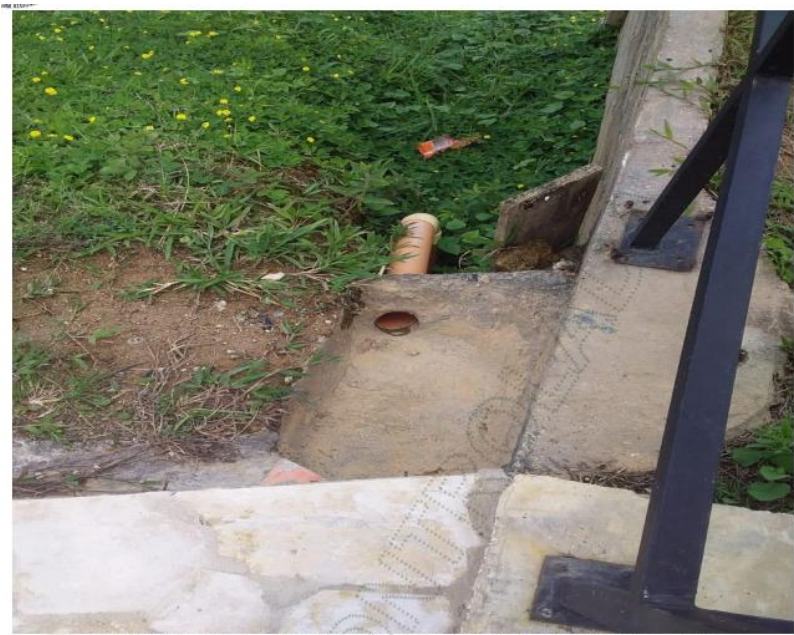
Imagen 3: Caja de empalme con tubería de 3" que conduce aguas lluvias hasta un lugar estable.
