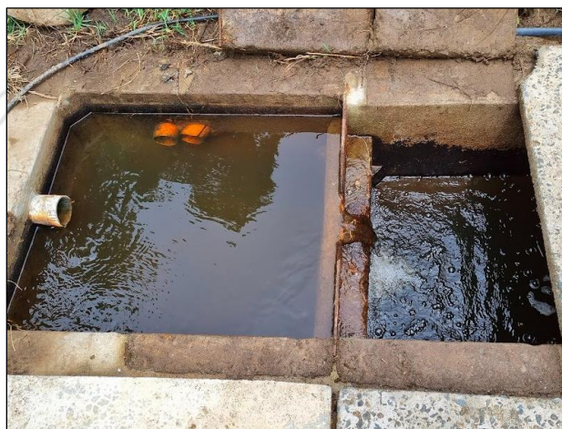
Imagen 2. Obra de Control de Caudal Usuarios Fuente Donde Juvenal.
