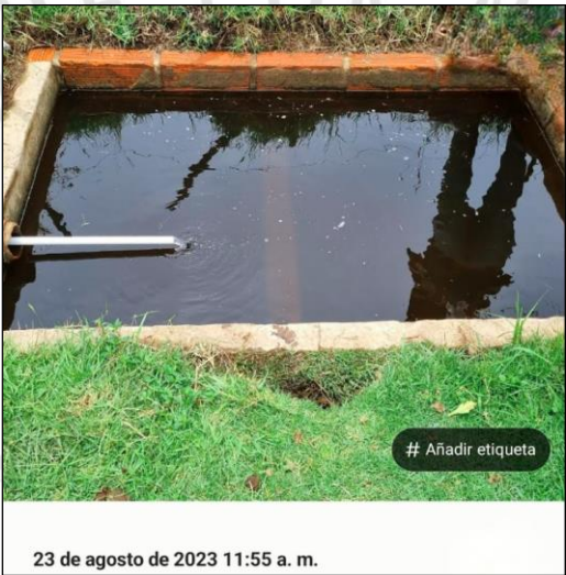
Imagen 6. Obra captación y control de caudal fuente “Josecito”
