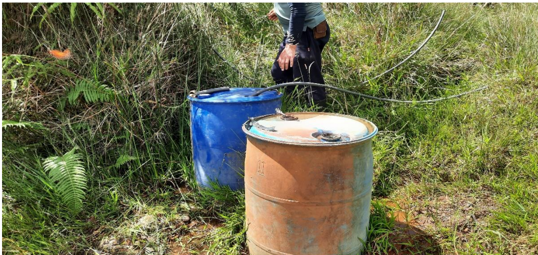
Obra de control de caudal
