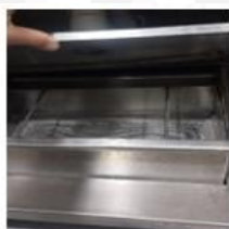
Imagen1. Trampa de Grasas (Zona de asados cocina).
