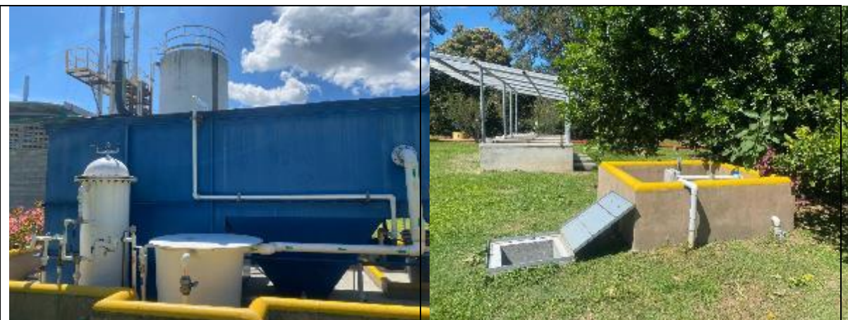
Planta de Tratamiento de Aguas Residuales Domésticas
