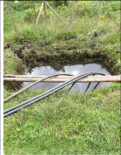
Imagen 3: Sistema de Bombeo de succión.
