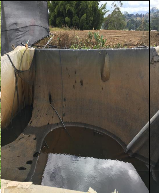
Imagen 4: Tanque de Almacenamiento
