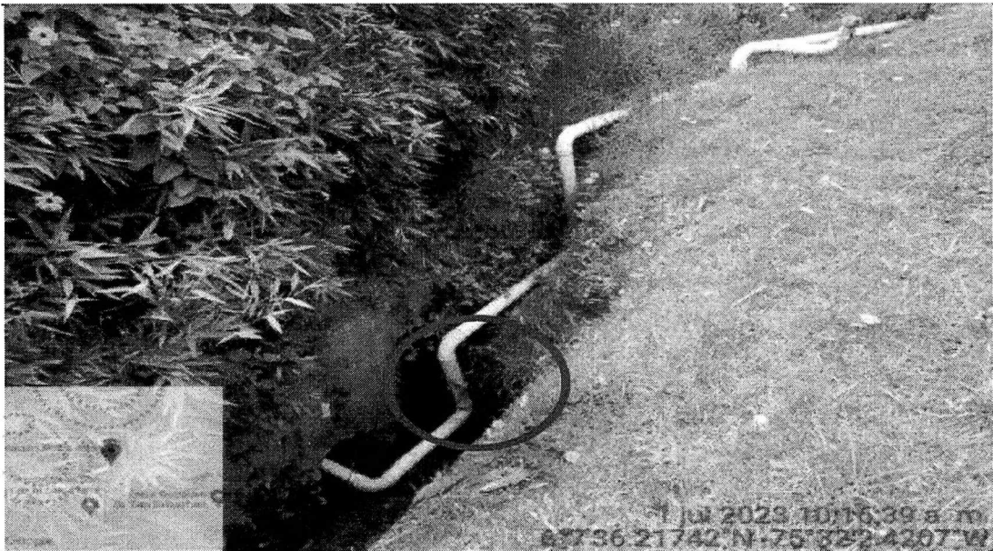
Recorrido de la tubería y del vertimiento antes de cruzar la calle principal de la Parcelación Roble alto. En la zona resaltada se puede apreciar el vertimiento.
