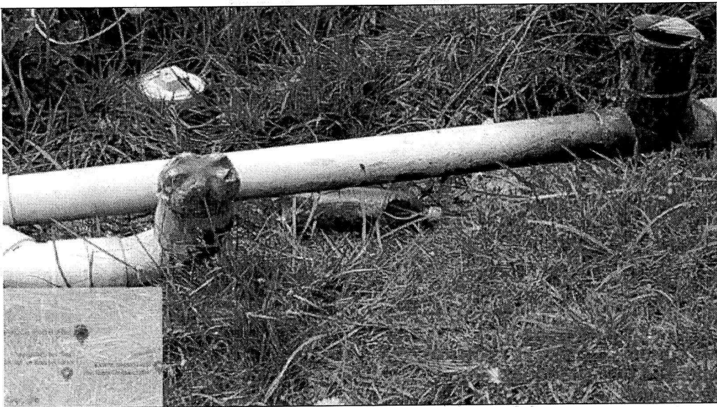
Salidas adicionales de la tubería de descarga
