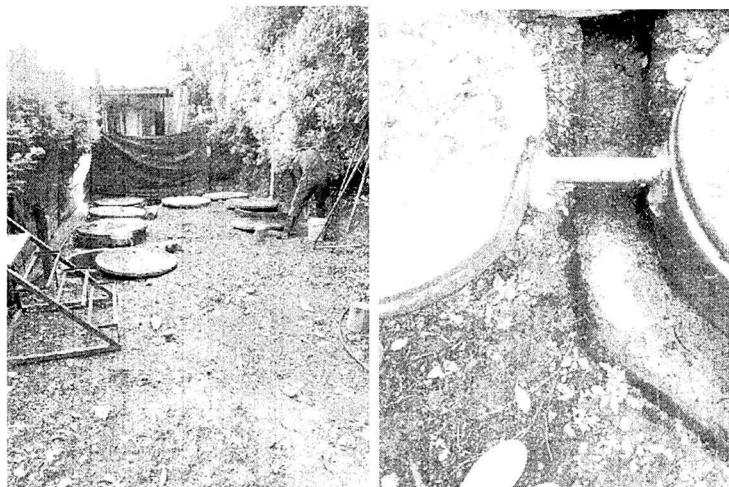
Imagen 1. Sistema de tratamiento implementado
