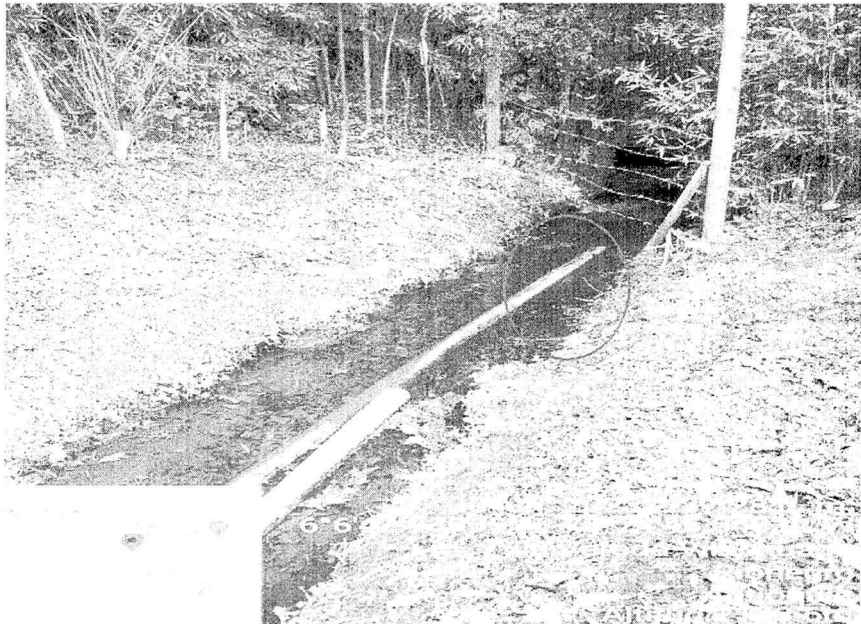
Tubería de descarga de la parcelación Casa de Campo. Coordenadas: -75° 30' 0.6" W 6° 17' 30.3" N
