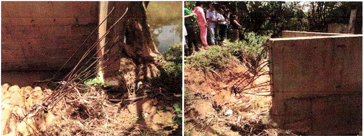
Fotografía 3. Varillas en muro de azud en la margen izquierda de la quebrada San Roque. Fuente: CORNARE (10/08/2023)
