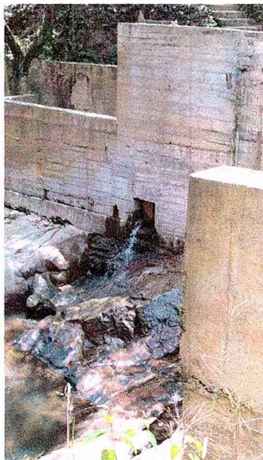
Fotografía 1. Compuerta de caudal ecológico cerrada Fuente: CORNARE (10/08/2023)
