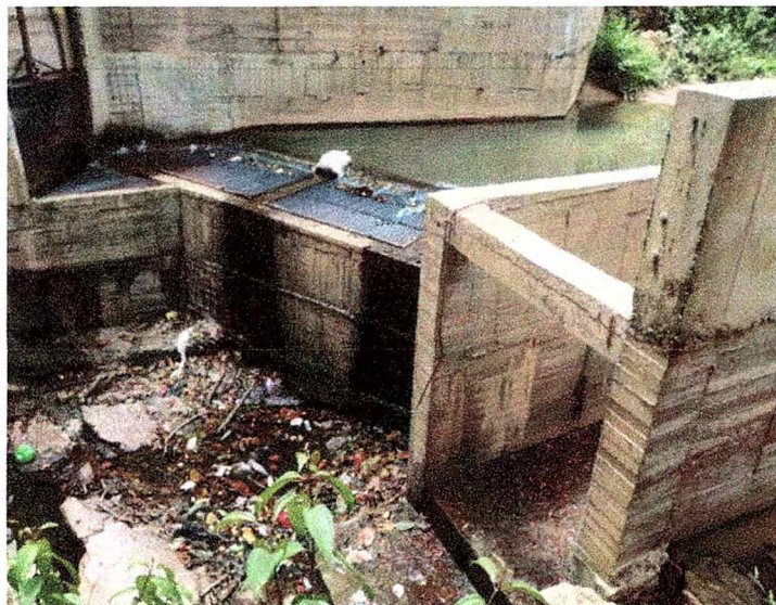
Fotografía 4. Residuos sólidos aguas abajo del azud. Fuente: CORNARE (10/08/2023)
