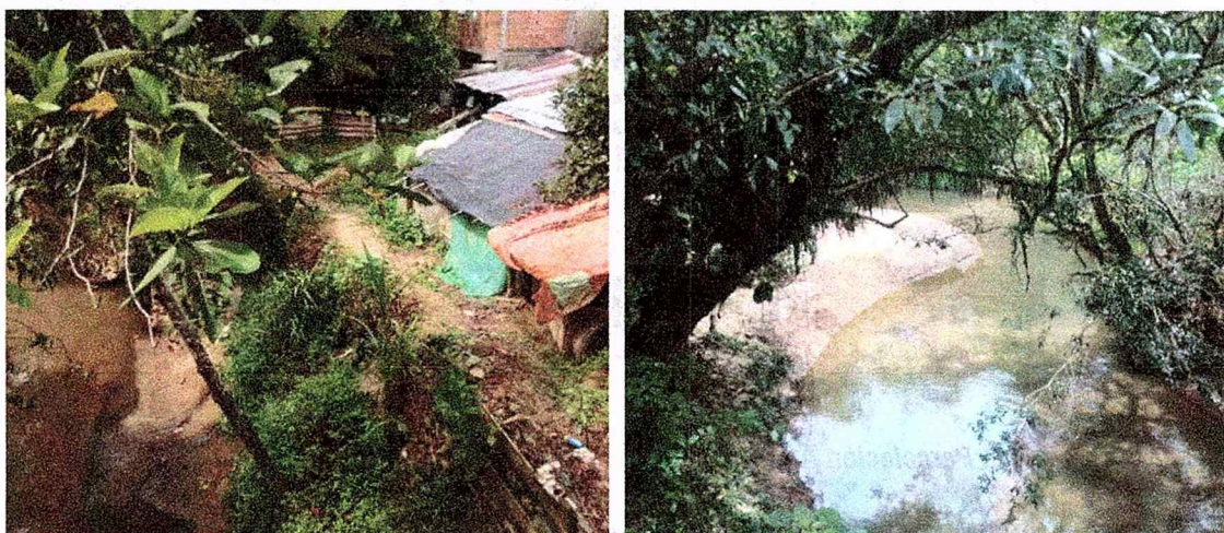
Fotografía 5. Muro en gavión y barra de sedimentos de la quebrada San Roque en el sector de Puente Negro. Fuente: CORNARE (10/08/2023)
