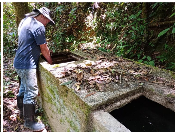
Imagen # 3 Tanque desarenador
