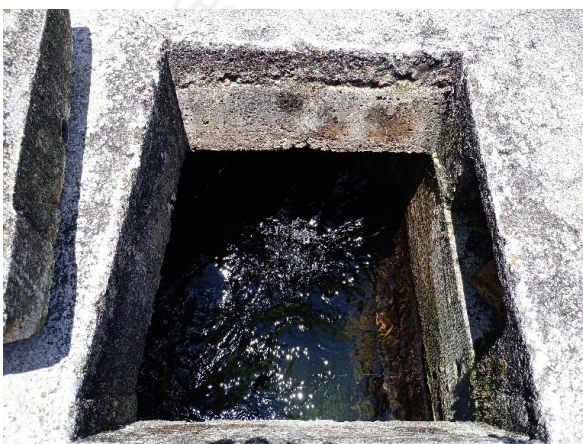
Imagen # 4 tanque de almacenamiento
