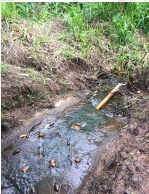
Imagen 4: Descarga del rebose con estructura de discipacion que evita erosion en el borde del cauce de la fuente.
