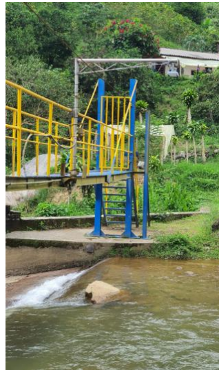
Sensor medición del caudal
