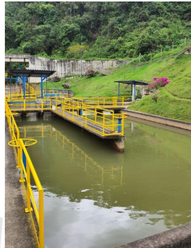
Tanque de carga
