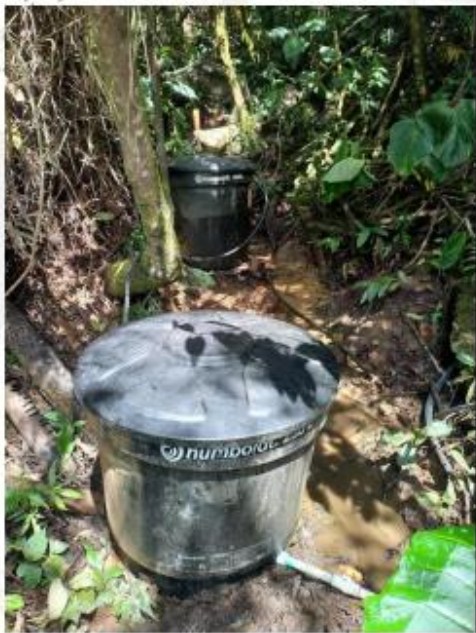
Imagen 2. Tanques – obra de control
