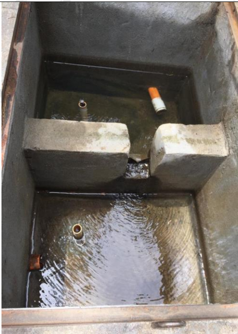
Imagen 3: Obra De Control De Caudal Fuente la Guinea
