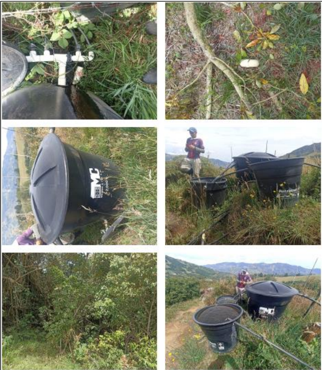
Tanques de almacenamiento, Pozo séptico y controles de flujo
