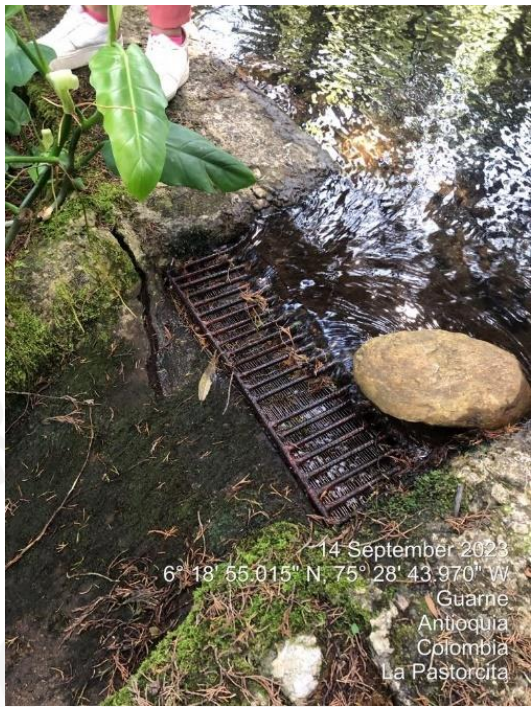
Ilustración 3. Rejilla de captación del acueducto
