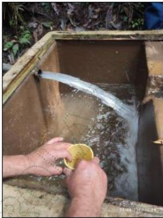
Figura 2. Obra de captación y control de caudal conjunta
