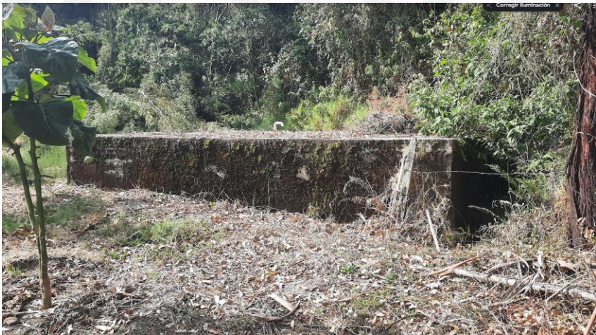
Tanque de Almacenamiento de 10 metros cúbicos
