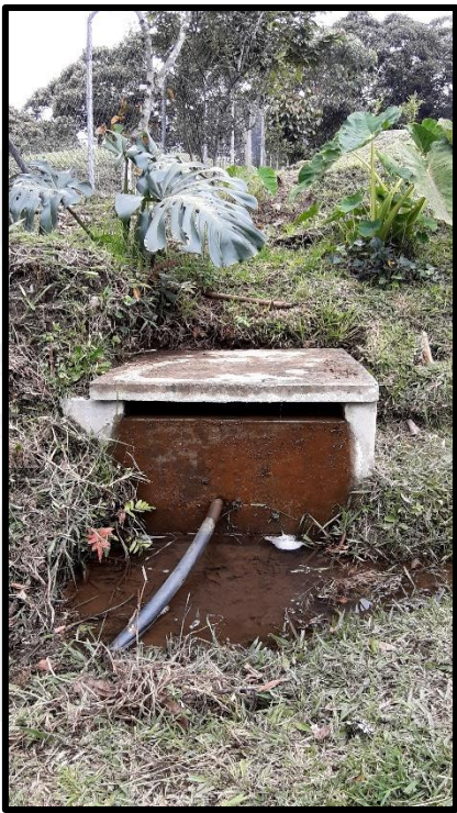
Imagen 9. Tanque donde se unen las aguas del Ramal 1 y 2.
