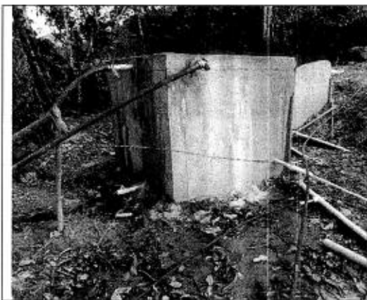
Imagen 13. Tanques de almacenamiento de agua.
