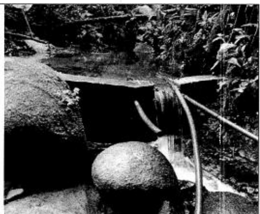
Imagen 14. Obra de captación de donde se conduce el recurso hasta los tanques.
