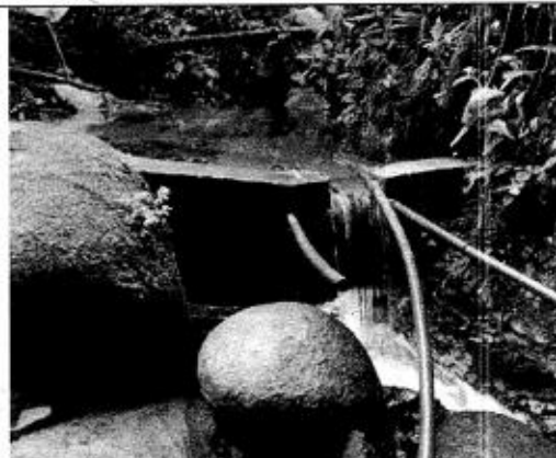
Figura 13. Obra de captación de donde se conduce el recurso hasta los tanques.
