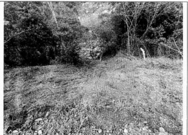
Imagen 10. Talud erosionado, depositando sedimentos al río Dormilón.
