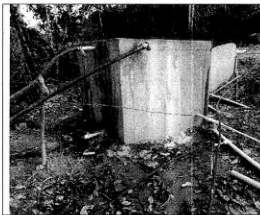
Imagen 13. Tanques de almacenamiento de agua.
