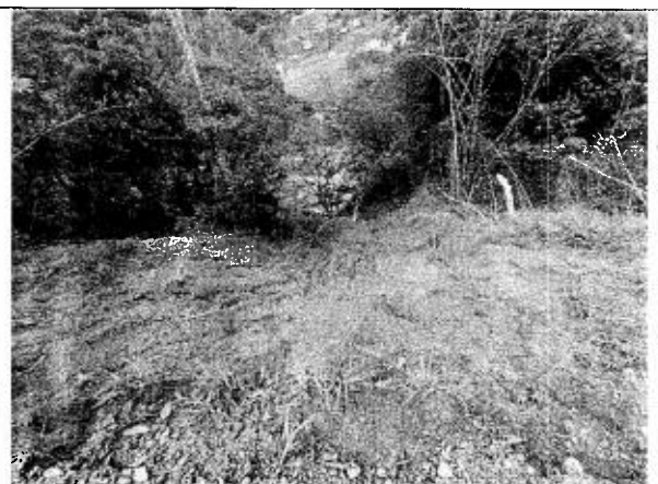
Imagen 10. Talud erosionado, depositando sedimentos al río Dormilón.
