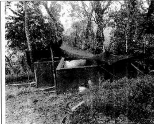
Figura 12. Tanques de almacenamiento de agua.
