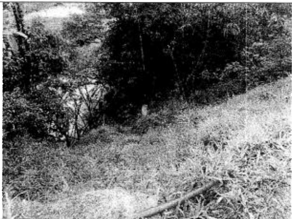
Figura 8. Talud cerca al río Dormilón, después.
